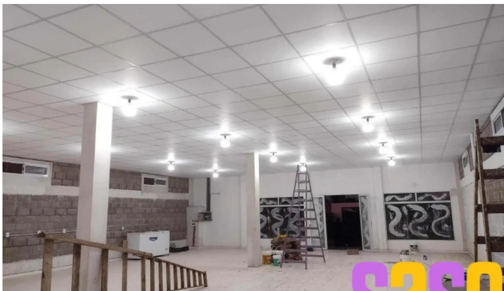
Gallego electricidad interior
