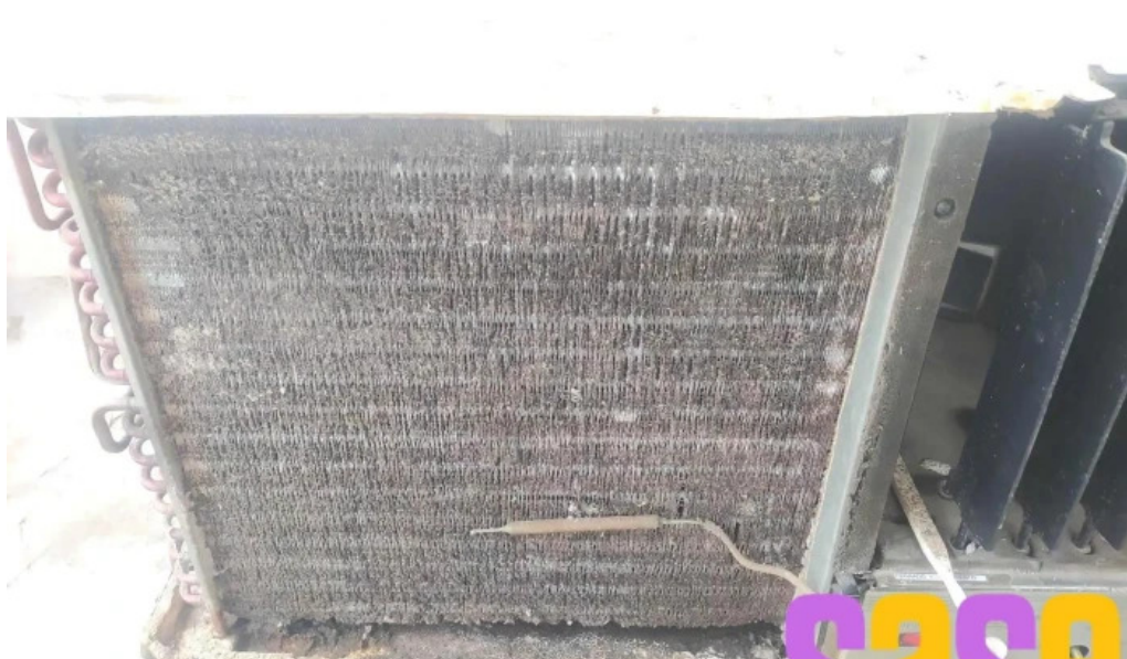
Servicios de gas refrigeracion y electricidad del propietario
