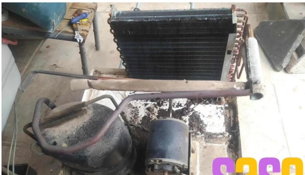
Servicios de gas refrigeracion y electricidad zona
