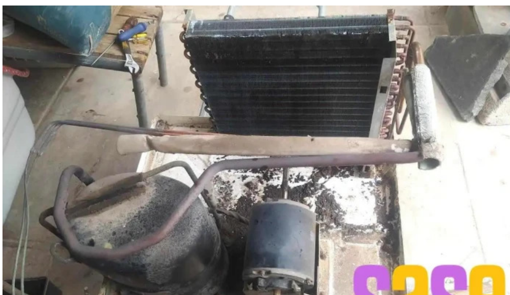
Servicios de gas refrigeracion y electricidad parana
