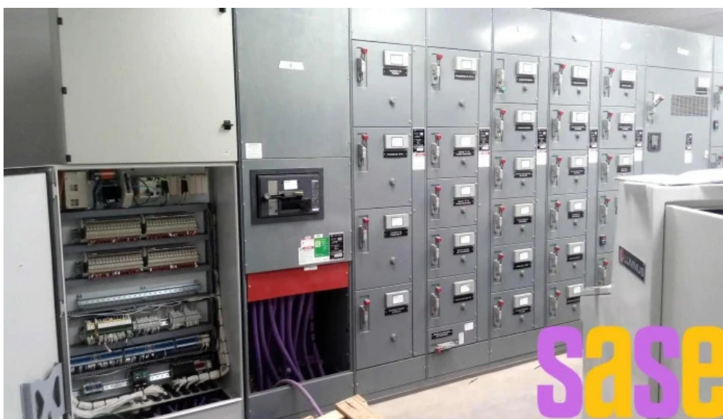
Construcciones electricas zorzan sa del propietario
