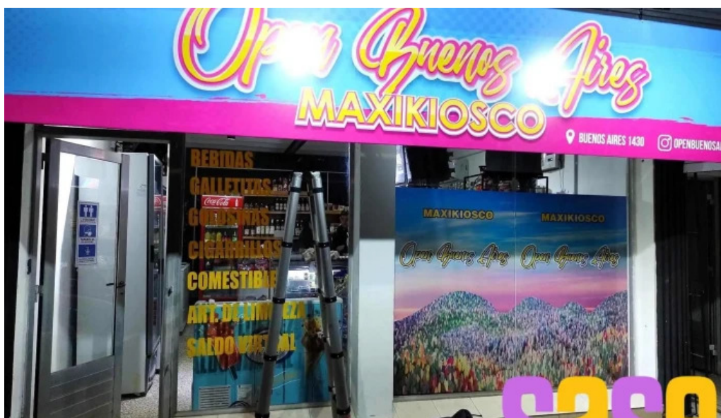
Gl electricidad exterior
