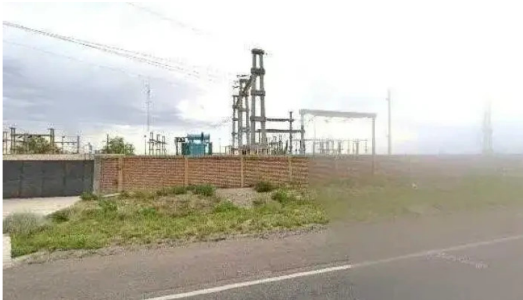
Edemsa estacion transformadora tupungato ubicacion
