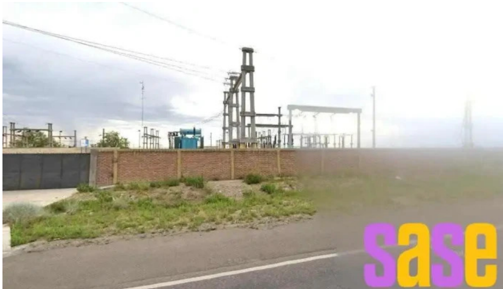
Edemsa estacion transformadora tupungato tupungato
